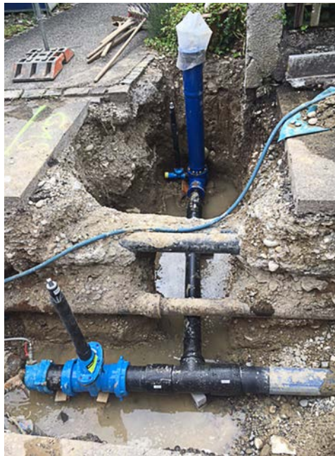
Anschluss eines Hydranten. Vorne links ist ein Schieber eingebaut.
