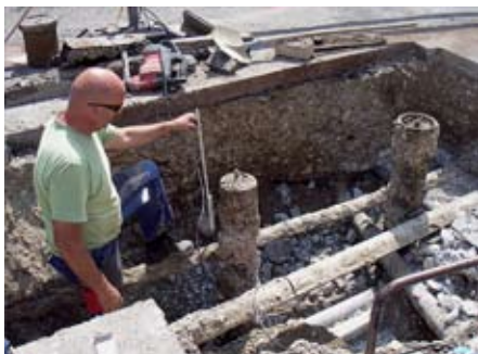
Schwierige Arbeiten für unseren Brunnenmeister Roger Joggi im Gewirr von Leitungen für Gas, Strom, Telefon und Wasser (Rüttenenstrasse, 25. August 2009).
